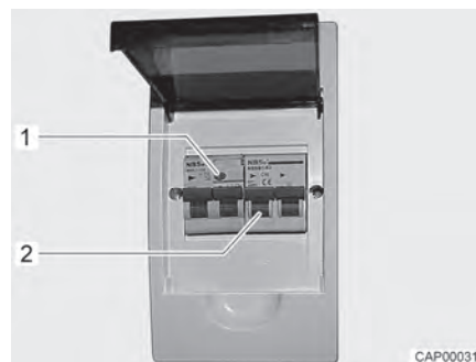
Bild 90 230-V-Sicherungskasten mit Leitungsschutzschalter und FI-Schalter
